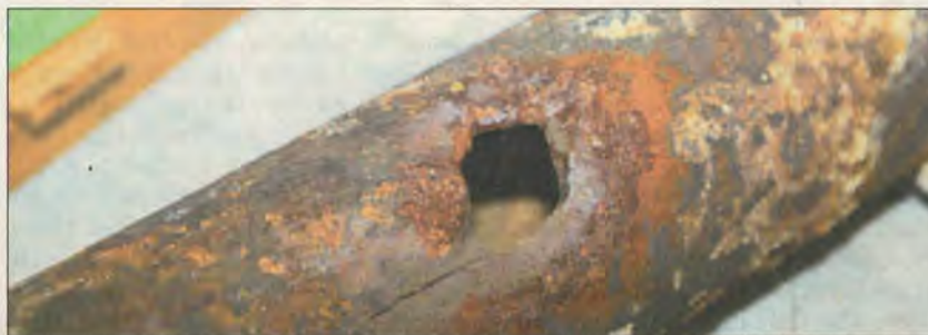
Der Bereitschaftsdienst des Wasserzweckverbandes ist rund um die Uhr erreichbar, um Rohrbrüche wie diesen (hier ein Ausstellungsstück, das für Schulungszwecke aufgehoben wird) zu beheben. (Fotos: gt)
