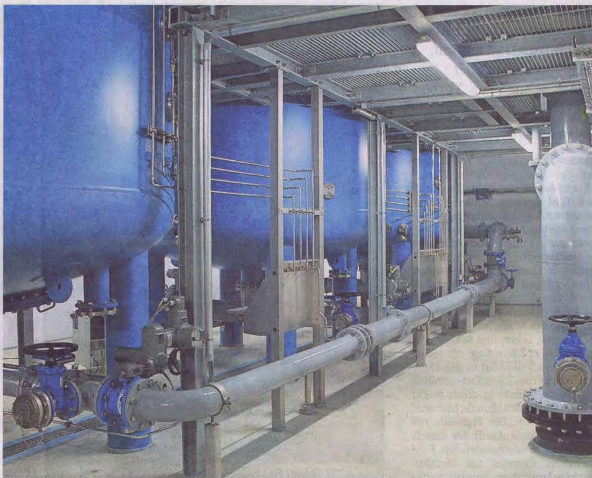
Die drei Behälter der Aufbereitungsanlage – darin filtern Aktivkohle die Hinterlassenschaften der Landwirtschaft aus dem Wasser.
