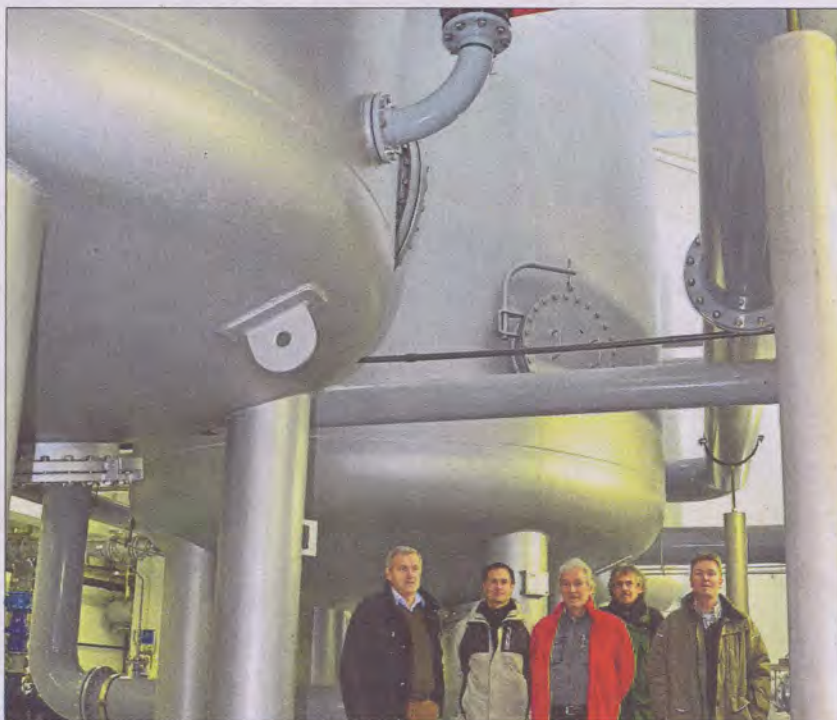
Hans Weinzierl, Ingenieur Mirko Wand (seit Januar Technischer Betriebsleiter des Zweckverbands), Klaus Sixt und ein Mitarbeiter von Sixt, Heiß und Partner sowie Wassermeister Martin Meister besichtigten beim Zweckverband Laber-Naab eine Aktivkohleaufbereitung. (Foto: Zweckverband Rottenburg)
